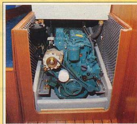
De motor staat stevig op stalen profielen die zijn bevestigd aan de fundatie.
